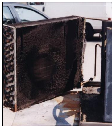
prima del trattamento
