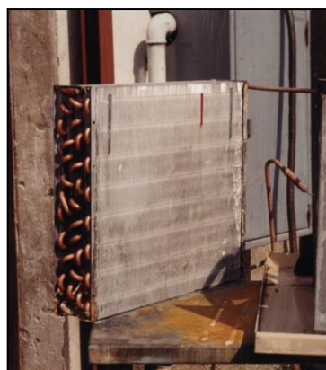
dopo il trattamento
